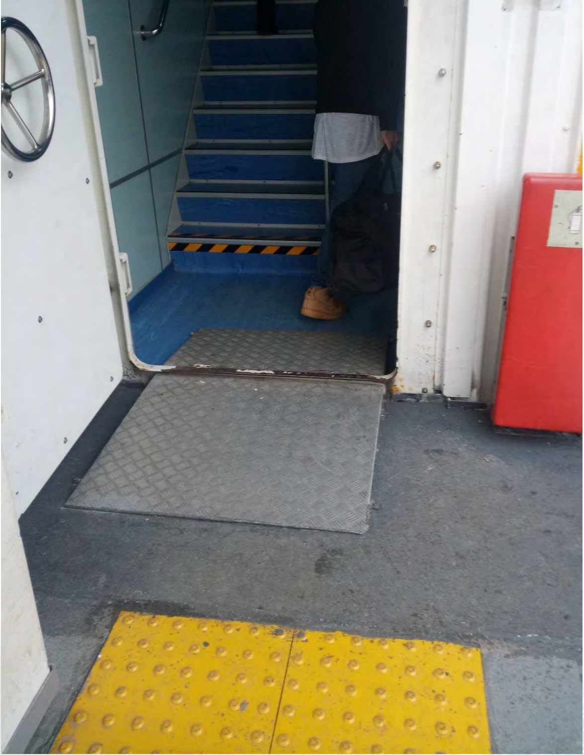
Fotoğraf 33. İDO İstanbul Yalova seferi, kapı eşiğine rampa yapılmış fakat yaklaşık 3 cm yükselti kalmış. Rampanın merdiven tarafında yeterli sahanlık yok.
